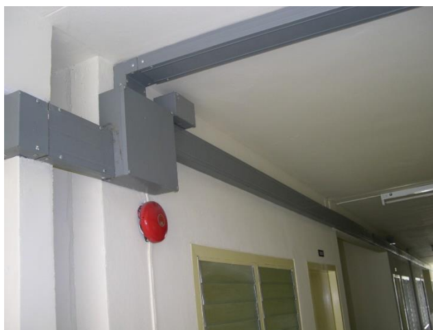
รูปที่ 2.33 ตัวอย่างการติดตั้งใช้งานรางเดินสาย
