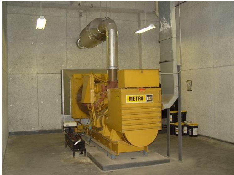
รูปที่ 1.46 เครื่องกำเนิดไฟฟ้า
