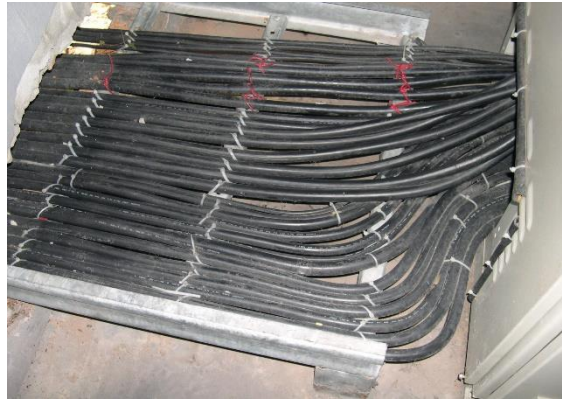
รูปที่ 2.36 ตัวอย่างการวางสายและการมัดสายบนรางเคเบิล
