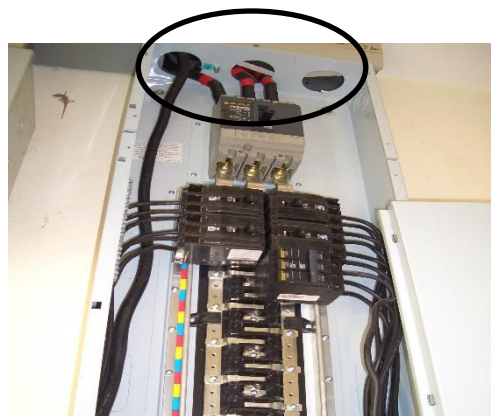
รูปที่ 2.8 ตัวอย่างการร้อยสายที่ไม่ถูกต้อง (ไม่รวมในรูเดียวกัน)
