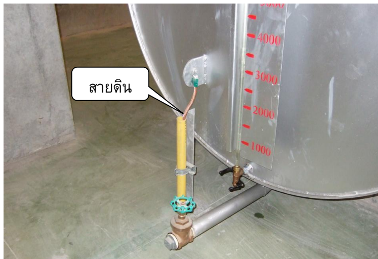
รูปที่ 1.62 ตัวอย่างการต่อลงดินถึงน้ำมันเพื่อการคายประจุ
